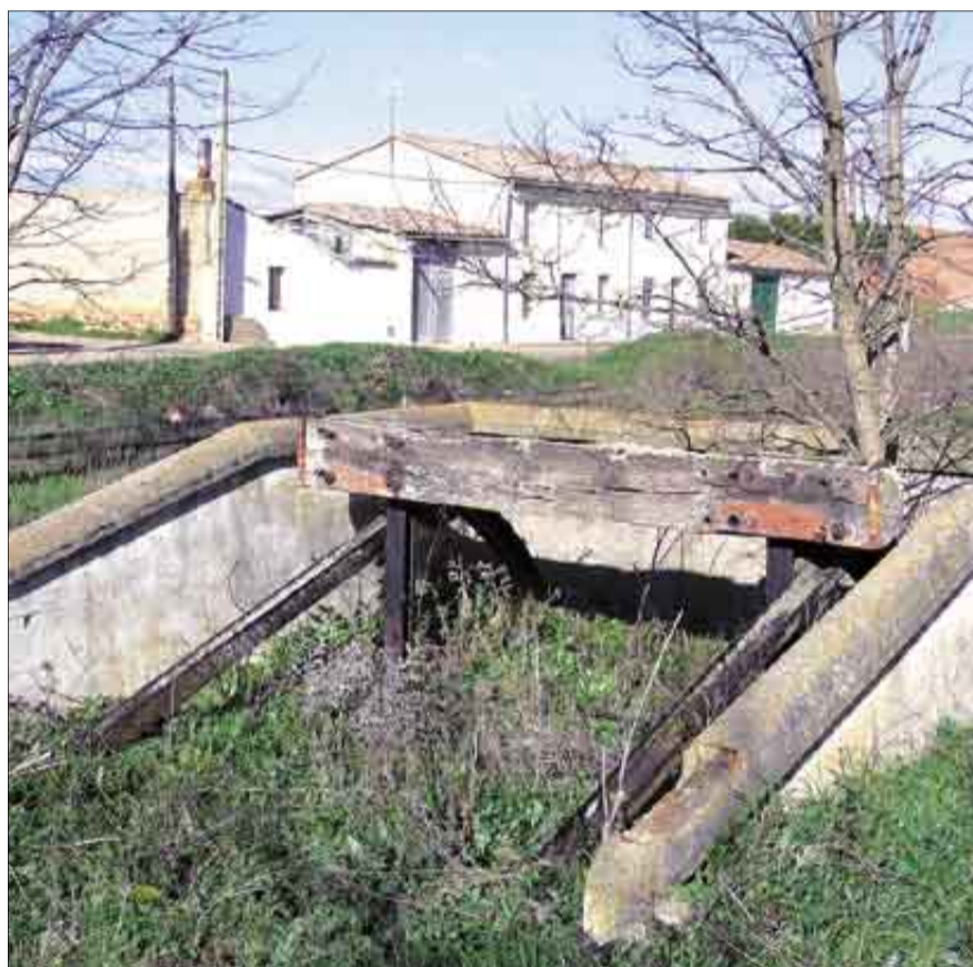
A la izquierda, vías en desuso de la Ruta de la Plata a su paso por Tierra de Campos. Arriba, uno de los topes utilizados por los trenes lleno de maleza y basura.
